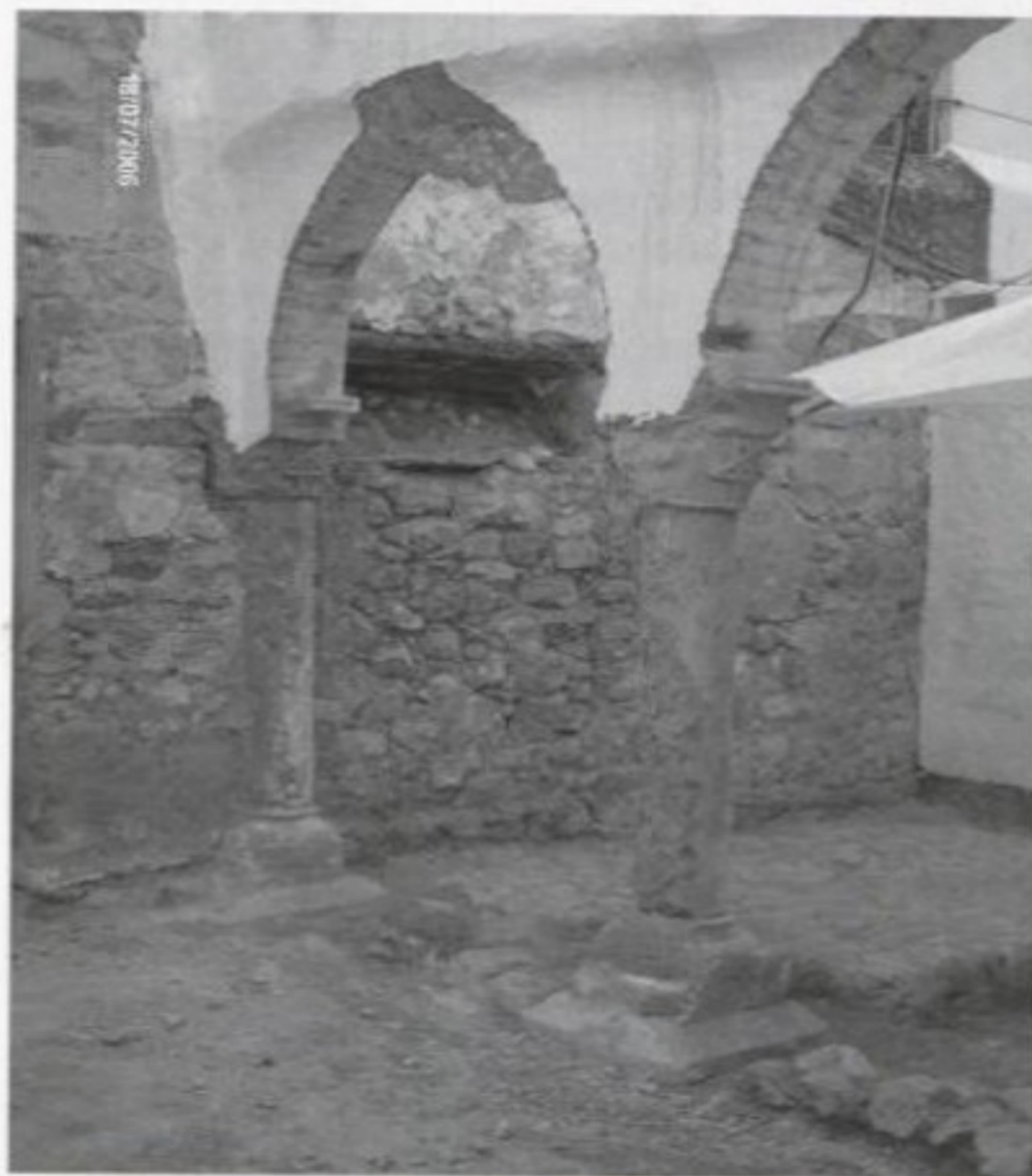
Ilustração 2 – Aspecto das colunas que se encontravam no interior de uma das paredes
