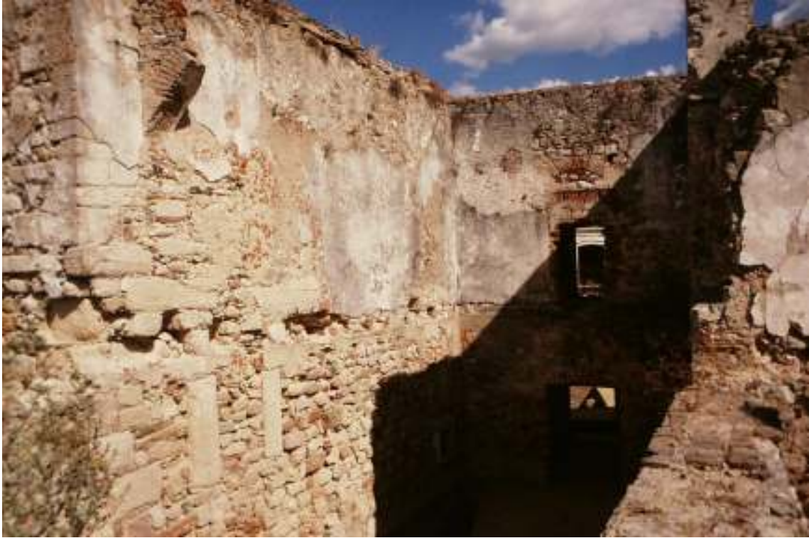
Fig. 24. Aparelho construtivo da face poente da torre 3 (imagem cedida pelo Gabinete de Arqueologia da Câmara Municipal de Alcácer do Sal).
