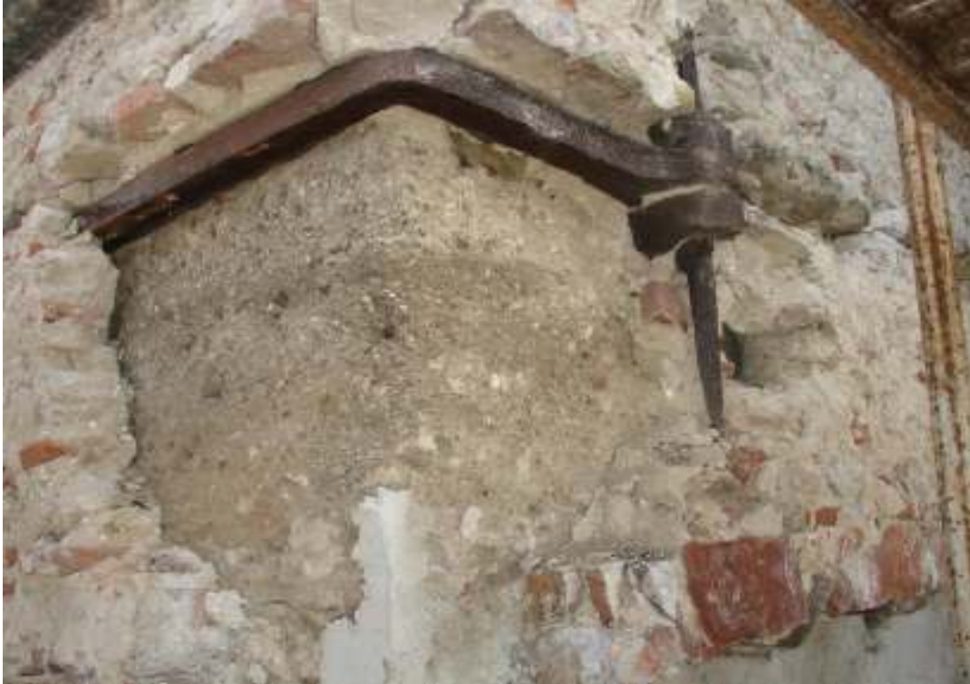
Fig. 94. Interior construído em taipa da torre do relógio identificado durante as obras de restauro (fotografia de Balona).
