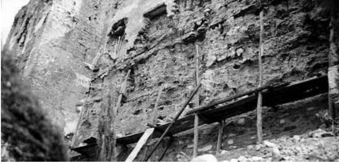
Fig. 54. Torre 9 vista do exterior da alcáçova durante os restauros da DGEMN em 1981 (imagem do inventário D.G.E.M.N.: INV/DGEMN).
