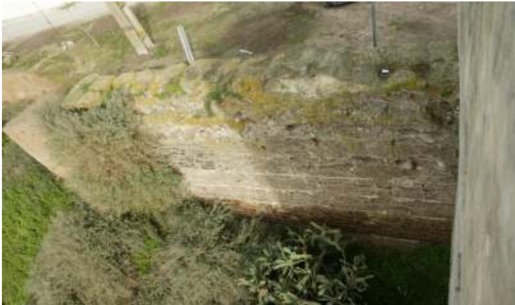
Fig. 95. Pano de muralha que se segue a partir da Torre do Relógio onde é visível as marcas dos quadriláteros desenhados sobre a taipa.
