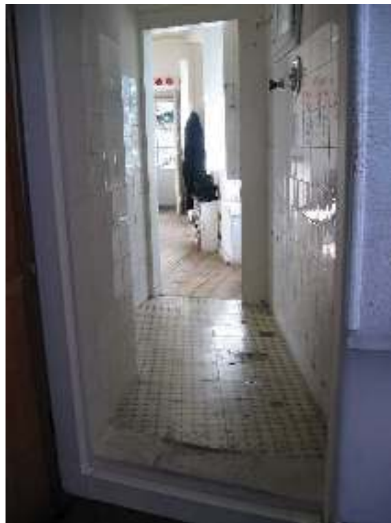
Figura 22 - Acesso de ligação entre a casa do caseiro e os gabinetes, temporariamente instalados no primeiro piso. (Fonte: IHRU)
