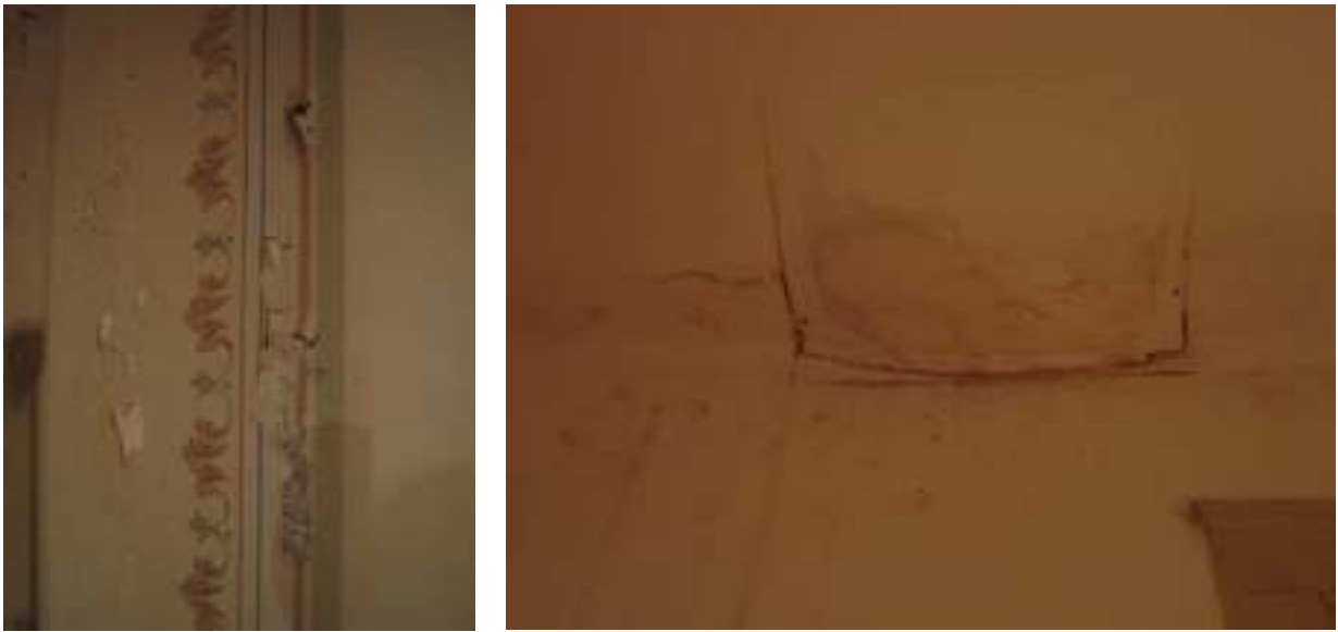
a) Parede de uma das salas do andar nobre, onde é perceptível a deterioração da pintura b) Tecto de uma das salas, onde são visíveis os danos causados pelas infiltrações.
